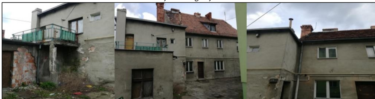
Ilustracja 9. Obszar rewitalizacji, budynek przy ul. Bydgoskiej 2, działka nr 484/2 - zły stan stwierdzono w 7 na 8 kryteriów ogólnych
