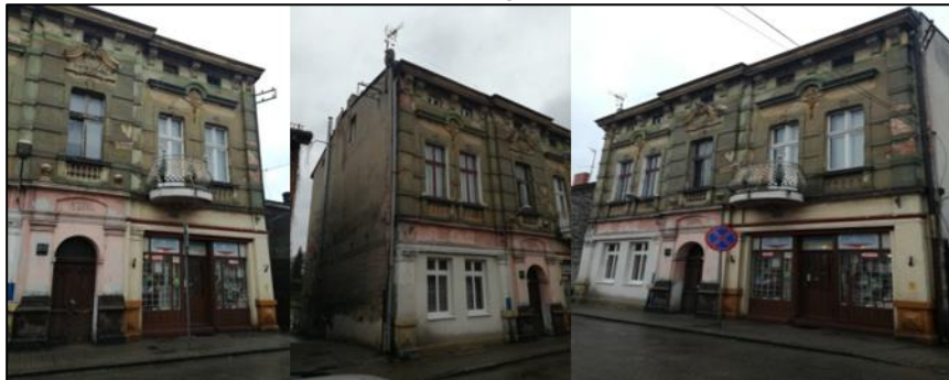
Ilustracja 16. Obszar rewitalizacji, budynek przy ul. Toruńskiej 2, działka nr 702 - zły stan stwierdzono w 7 na 8 kryteriów ogólnych
