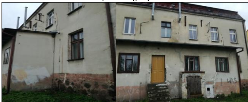
Ilustracja 13. Obszar rewitalizacji, budynek przy Placu Jana Pawła II 4, działka nr 626 - zły stan stwierdzono w 8 na 8 kryteriów ogólnych
