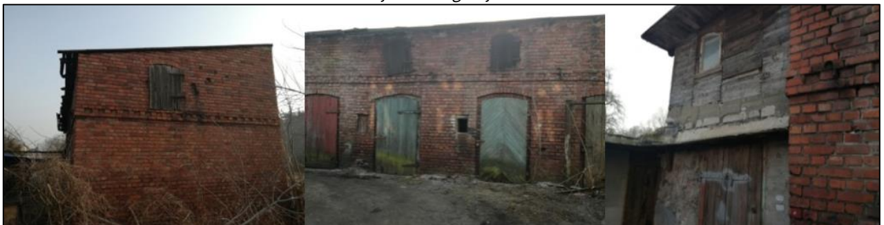
Ilustracja 17. Obszar rewitalizacji, budynek przy ul. Toruńskiej 16, działka nr 696 - zły stan stwierdzono w 6 na 8 kryteriów ogólnych
