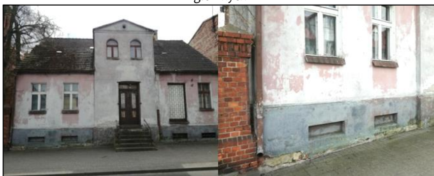
Ilustracja 12. Obszar rewitalizacji, budynek przy ul. Bydgoskiej 13, działka nr 452/2 - zły stan w 5 na 8 kryteriach głównych
