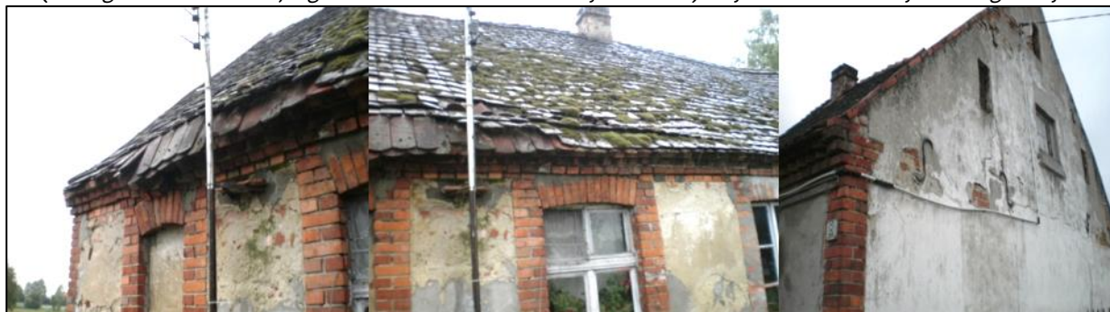
Ilustracja 4. Miasto, jednostka Leśne, ul. Błota 7, działka nr 18: przykład budynku uznanego za zdegradowany (którego stan konstrukcji ogranicza lub uniemożliwia użytkowanie) - zły stan w 8 na 8 kryteriach głównych
