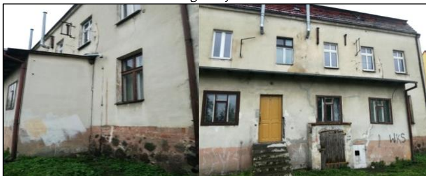
Ilustracja 14. Obszar rewitalizacji, budynek przy Placu Jana Pawła II 4, działka nr 626 - zły stan w 8 na 8 kryteriach głównych
