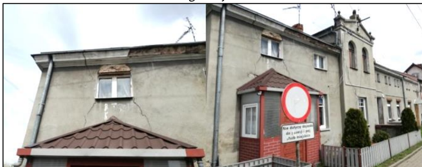
Ilustracja 13. Obszar rewitalizacji, budynek przy ul. Bydgoskiej 14, działka nr 463 - zły stan w 7 na 8 kryteriach głównych
