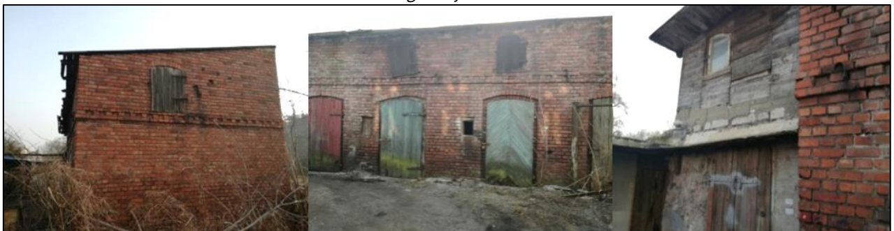
Ilustracja 18. Obszar rewitalizacji, budynek przy ul. Toruńskiej 16, działka nr 696 - zły stan w 6 na 8 kryteriach głównych
