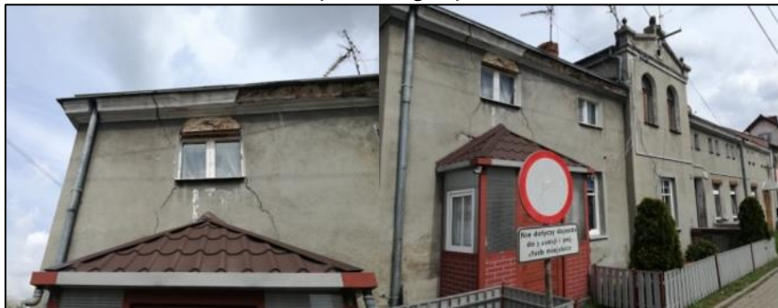
Ilustracja 12. Obszar rewitalizacji, budynek przy ul. Bydgoskiej 14, działka nr 463 - zły stan stwierdzono w 7 na 8 kryteriów ogólnych
