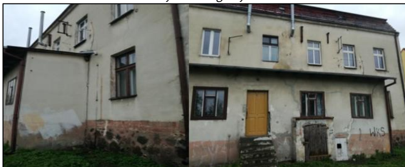
Ilustracja 13. Obszar rewitalizacji, budynek przy Placu Jana Pawła II 4, działka nr 626 - zły stan stwierdzono w 8 na 8 kryteriów ogólnych
