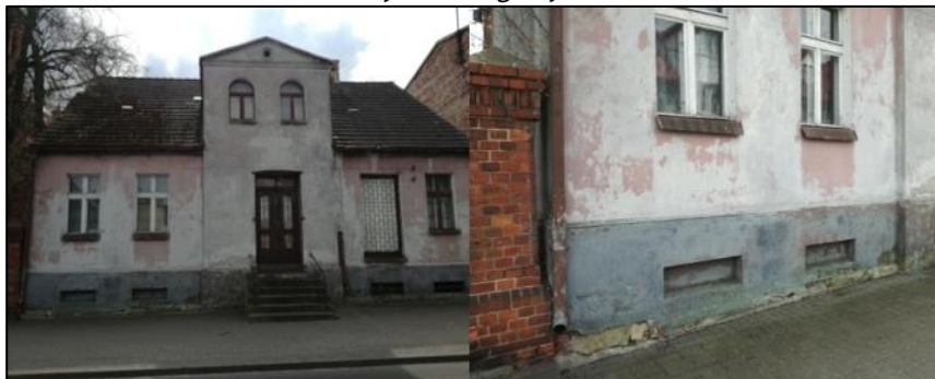
Ilustracja 11. Obszar rewitalizacji, budynek przy ul. Bydgoskiej 13, działka nr 452/2 - zły stan stwierdzono w 5 na 8 kryteriów ogólnych
