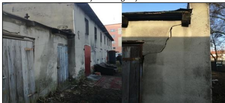
Ilustracja 15. Obszar rewitalizacji, budynek przy ul. 23 stycznia 15, działka nr 723/1 - zły stan stwierdzono w 5 na 8 kryteriów ogólnych
