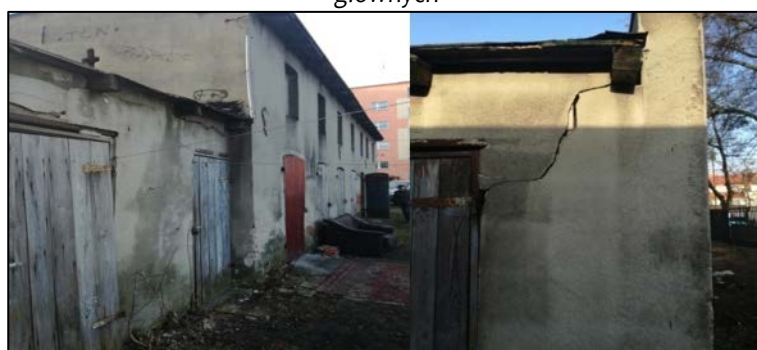
Ilustracja 16. Obszar rewitalizacji, budynek przy ul. 23 stycznia 15, działka nr 723/1 - zły stan w 5 na 8 kryteriach głównych
