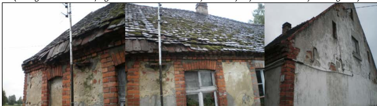
Ilustracja 4. Miasto, jednostka Leśne, ul. Błota 7, działka nr 18: przykład budynku uznanego za zdegradowany (którego stan konstrukcji ogranicza lub uniemożliwia użytkowanie) - zły stan w 8 na 8 kryteriach głównych
