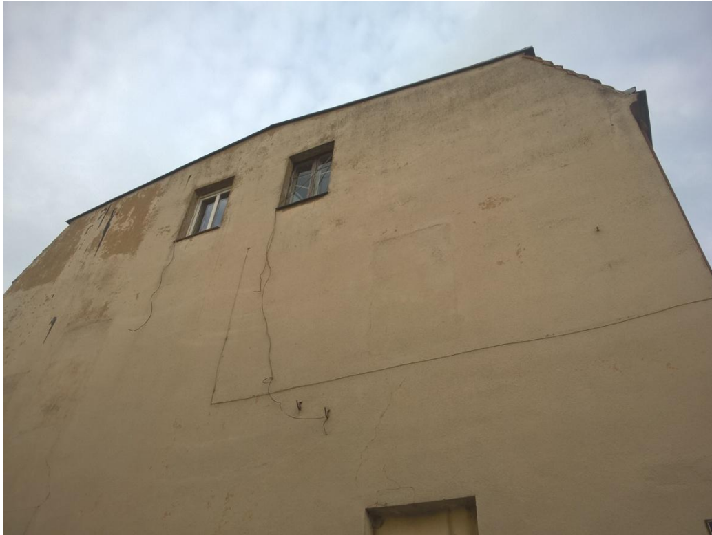
Fot. 1. Wschodnia elewacja budynku. Widoczne są okna strychu. Uchylenie jednego z okien umożliwi gołębiom dostęp do przestrzeni strychu.
