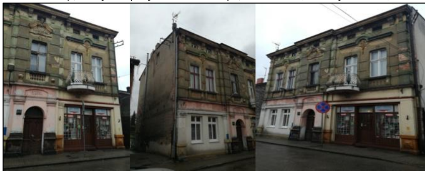
Ilustracja 17. Obszar rewitalizacji, budynek przy ul. Toruńskiej 2, działka nr 702 - zły stan w 7 na 8 kryteriach głównych
