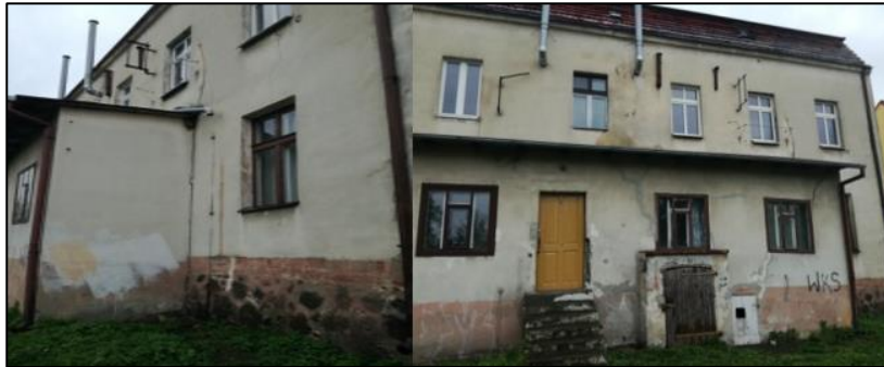
Ilustracja 14. Obszar rewitalizacji, budynek przy Placu Jana Pawła II 4, działka nr 626 - zły stan w 8 na 8 kryteriach głównych
