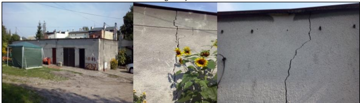
Ilustracja 15. Obszar rewitalizacji, budynek przy ul. 23 stycznia 2, działka nr 413/4 - zły stan w 5 na 8 kryteriach głównych
