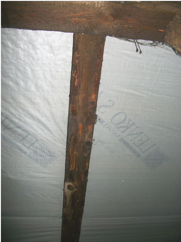
Fot. 7. Ubytek w strukturze przekroju krokwi K6 – koniczne wzmocnienie krokwi.
