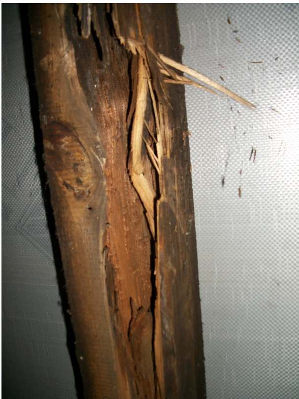
Fot. 6. Ubytek w strukturze przekroju krokwi K5 – koniczne wzmocnienie krokwi.
