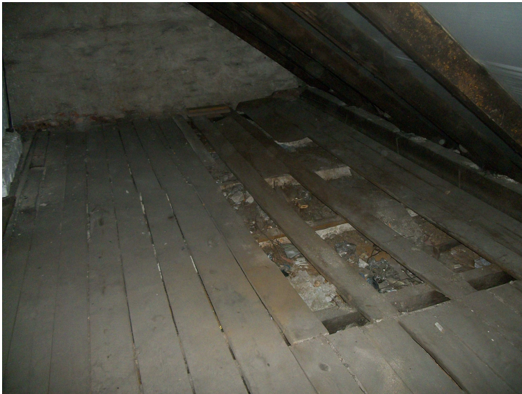
Fot. 8. Ubytki w deskowaniu podłogi strychu (około 5% powierzchni) – koniczne uzupełnienie w czasie prowadzenia prac związanych z dociepleniem poddasza.
