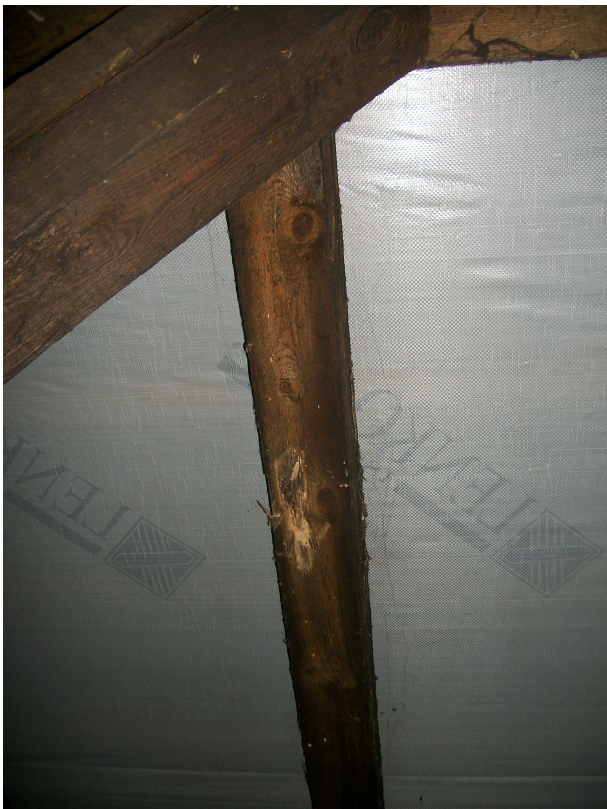
Fot. 5. Ubytek w strukturze przekroju krokwi K4 – koniczne wzmocnienie krokwi.
