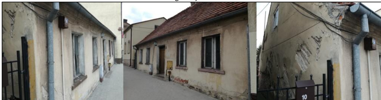
Ilustracja 11. Obszar rewitalizacji, budynek przy ul. Bydgoskiej 2, działka nr 410/1 - zły stan w 8 na 8 kryteriach głównych
