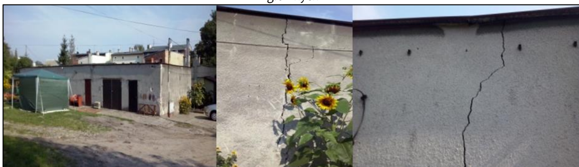
Ilustracja 15. Obszar rewitalizacji, budynek przy ul. 23 stycznia 2, działka nr 413/4 - zły stan w 5 na 8 kryteriach głównych
