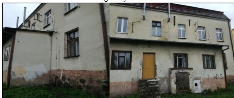
Ilustracja 14. Obszar rewitalizacji, budynek przy Placu Jana Pawła II 4, działka nr 626 - zły stan w 8 na 8 kryteriach głównych
