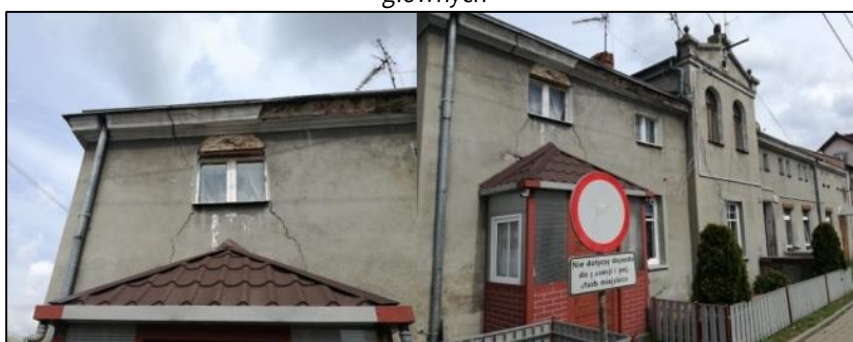
Ilustracja 13. Obszar rewitalizacji, budynek przy ul. Bydgoskiej 14, działka nr 463 - zły stan w 7 na 8 kryteriach głównych
