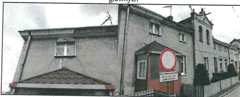
Ilustracja 13. Obszar rewitalizacji, budynek przy ul. Bydgoskiej 14, działka nr 463 - zły stan w 7 na 8 kryteriach głównych
