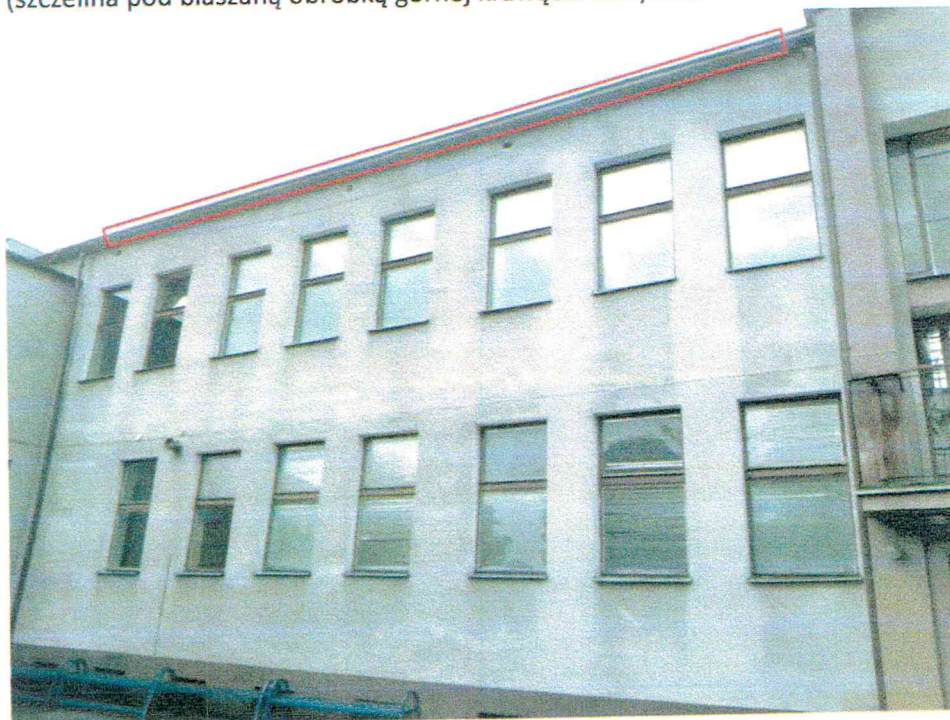
Fot. 1. Lokalizacja miejsca wylotu nietoperzy. Kolorem czerwonym zakreślono miejsce wylotu nietoperzy (szczelina pod blaszaną obróbką górnej krawędzi budynku).
