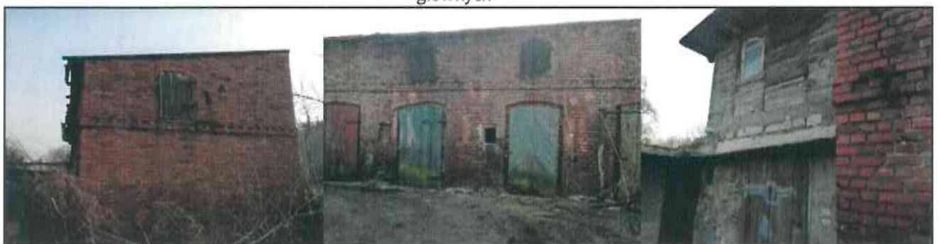
Ilustracja 18. Obszar rewitalizacji, budynek przy ul. Toruńskiej 16, działka nr 696 - zły stan w 6 na 8 kryteriach głównych
