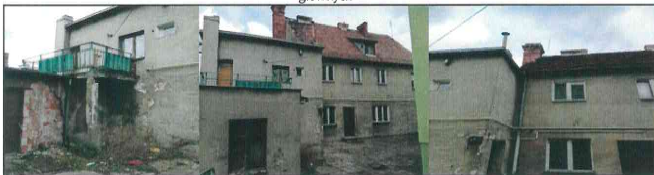
Ilustracja 10. Obszar rewitalizacji, budynek przy ul. Bydgoskiej 2, działka nr 484/2 - zły stan w 7 na 8 kryteriach głównych
