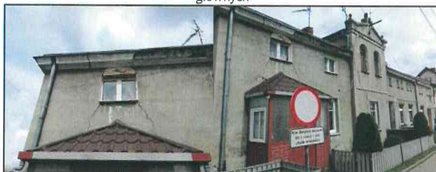
Ilustracja 13. Obszar rewitalizacji, budynek przy ul. Bydgoskiej 14, działka nr 463 - zły stan w 7 na 8 kryteriach głównych
