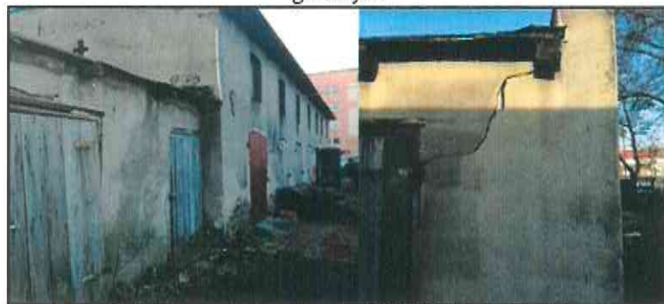
Ilustracja 16. Obszar rewitalizacji, budynek przy ul. 23 stycznia 15, działka nr 723/1 - zły stan w 5 na 8 kryteriach głównych
