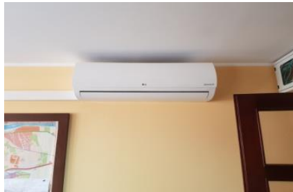
System klimatyzacji w budynkach UM
