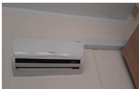
System klimatyzacji w budynkach UM
