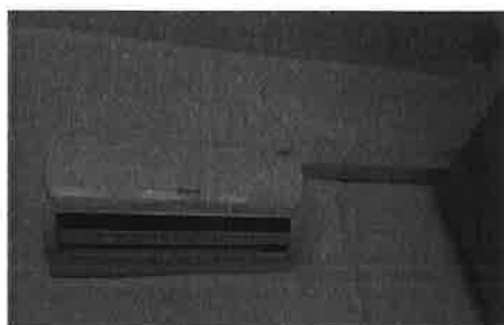
System klimatyzacji w budynkach UM
