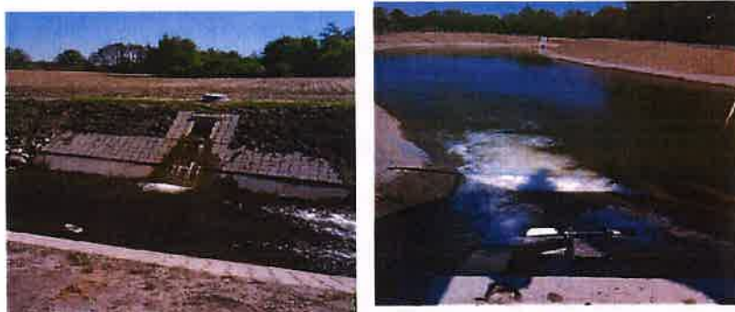
Zbiornik retencyjny i odprowadzenie wód deszczowych do Strugi Młyńskiej
