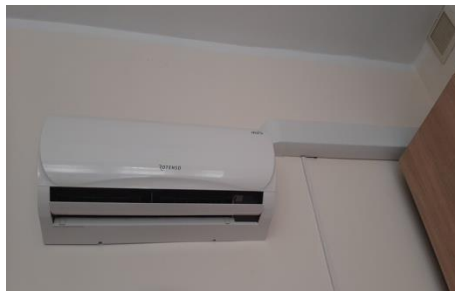
System klimatyzacji w budynkach UM
