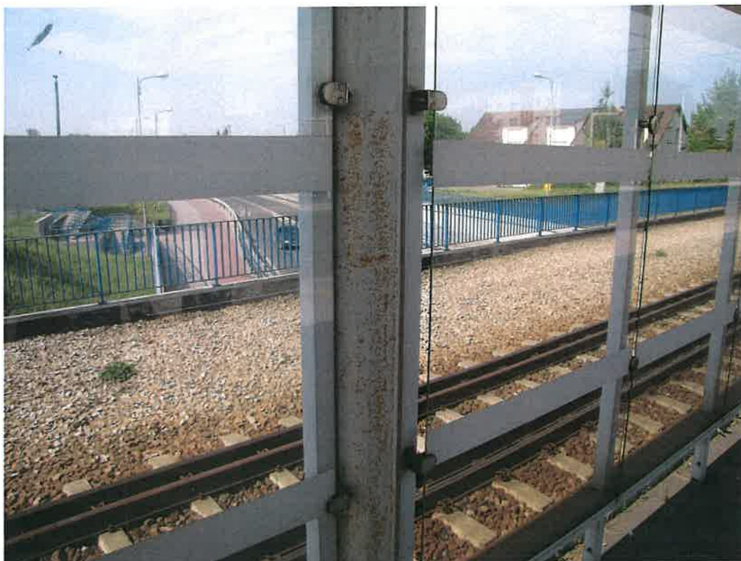
Fot. 9 – korozja stali słupów zadaszenie schodów wyjścia na peron w stadium początkowym
