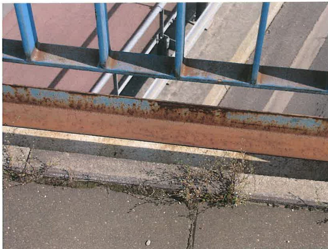
Fot. 12 – korozja elementów balustrady na gzymsie północnym, porost roślinności
