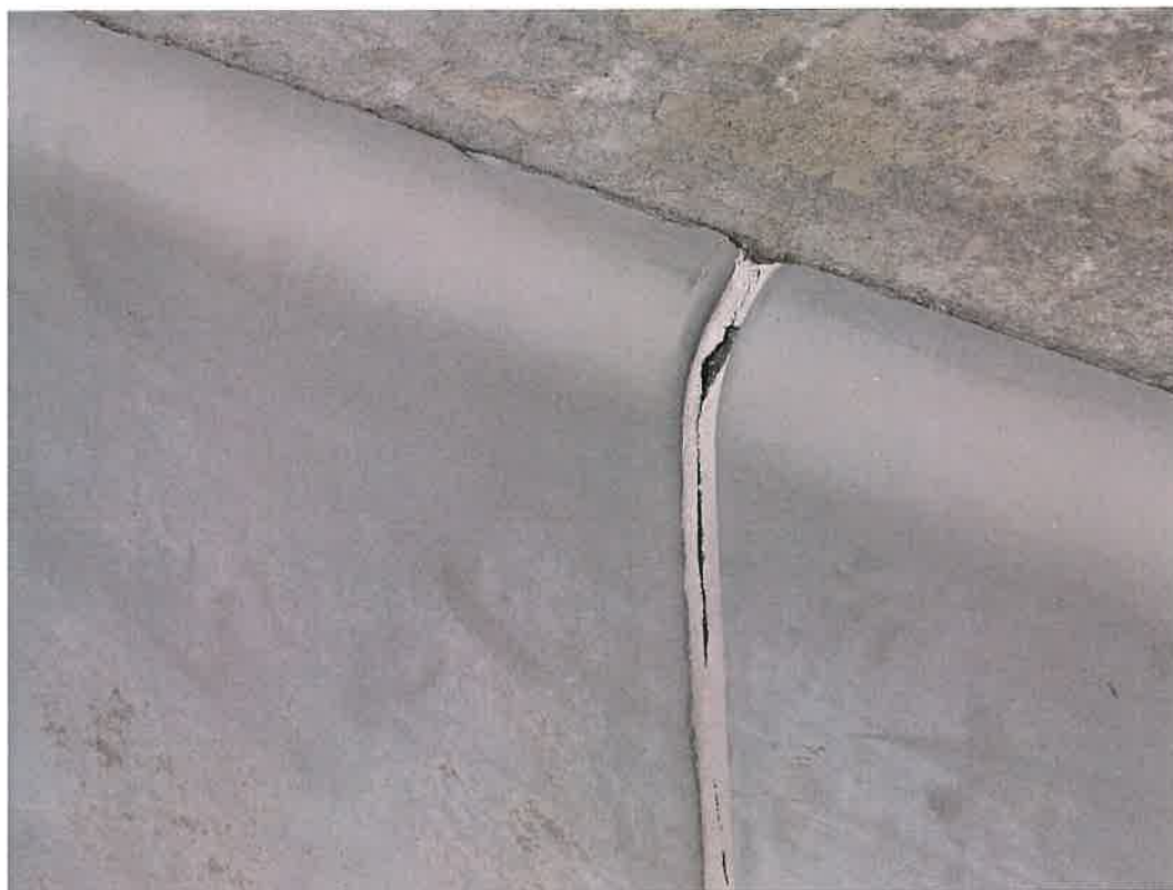
Fot. 26 – pęknięcie masy uszczelniającej styki desek gzymsowych ściany oporowej
