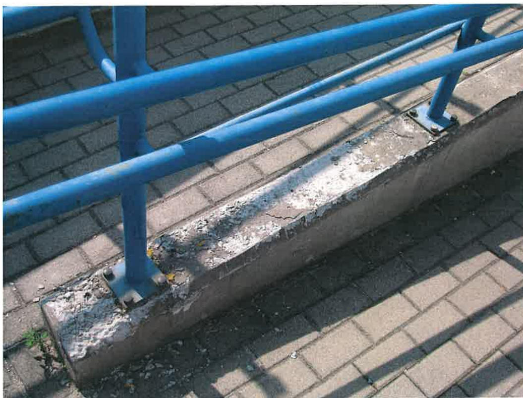
Fot. 31 – ubytki warstw ochronnych betonu na ściankach pochylni
