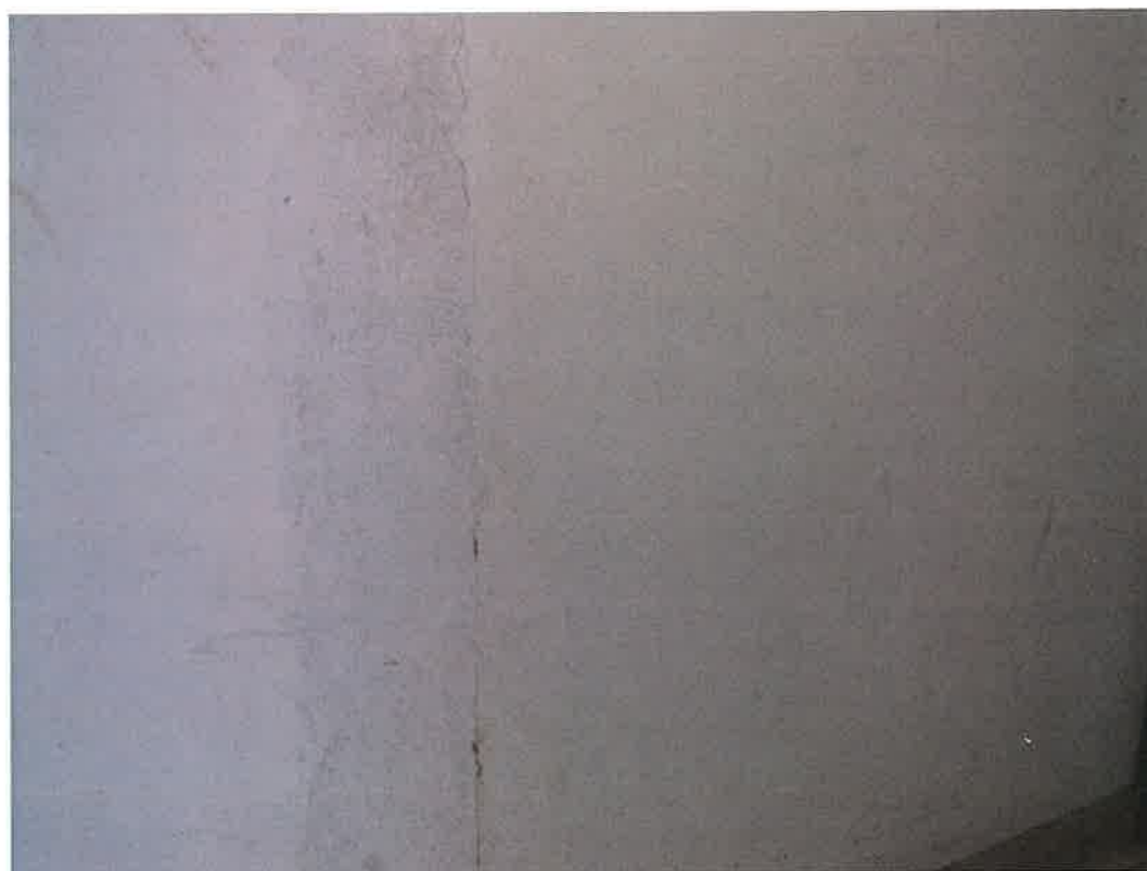
Fot. 22 – zarysowanie na styku przyczółka i łącznika do szybu windy
