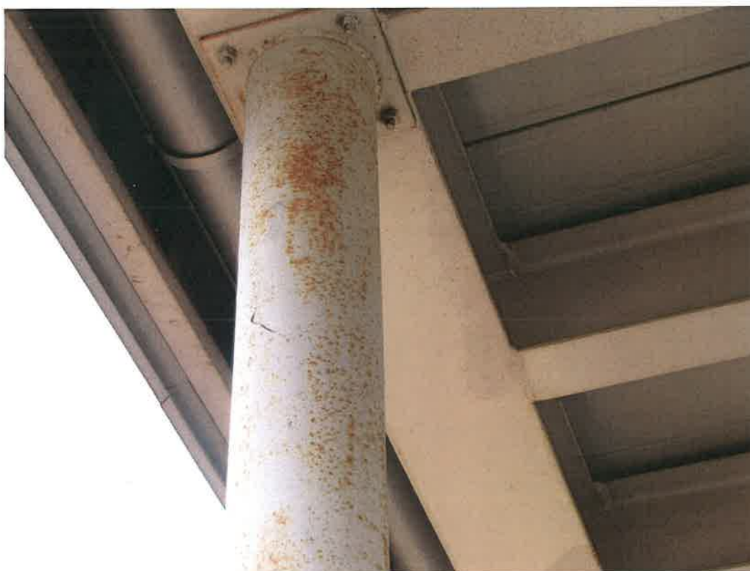
Fot. 10 – korozja stali słupów zadaszenie schodów wyjścia na peron w stadium początkowym
