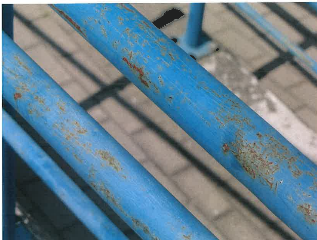
Fot. 29 – korozja przeciągów balustrady na pochylni
