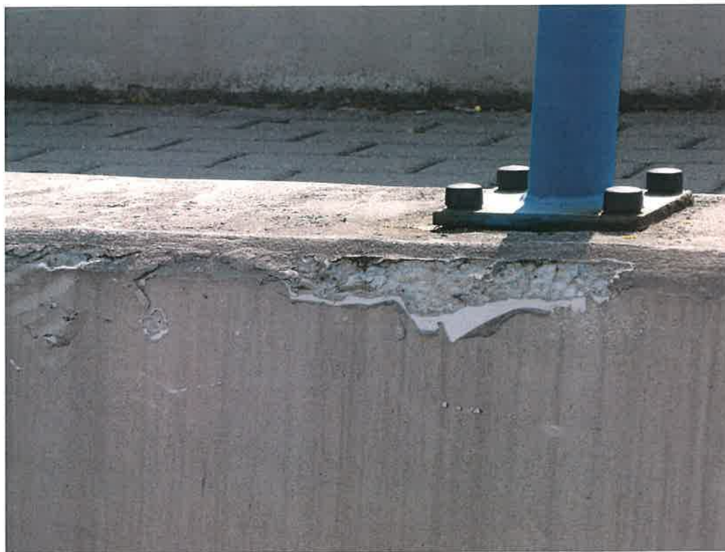
Fot. 32 – ubytki warstw ochronnych betonu na ściankach pochylni
