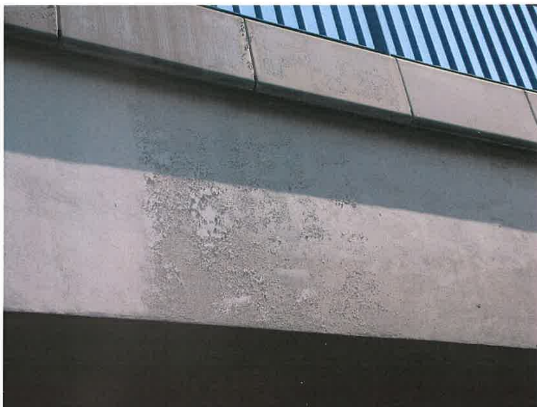
Fot. 14 – złuszczenie powłoki ochronnej do betonu na czole przęseł
