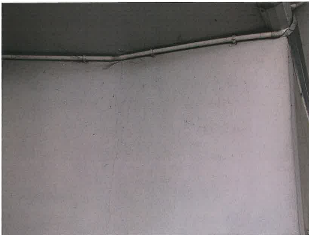
Fot. 20 – zarysowanie na styku przyczółka i łącznika do szybu windy
