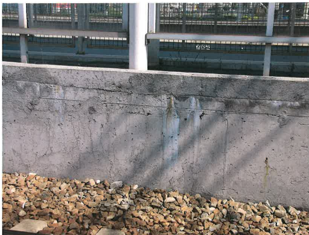
Fot. 18 – wykwity na powierzchni betonowej peronu (od strony torowiska)
