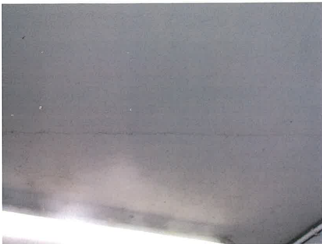
Fot. 21 – zarysowanie na styku przyczółka i łącznika do szybu windy
