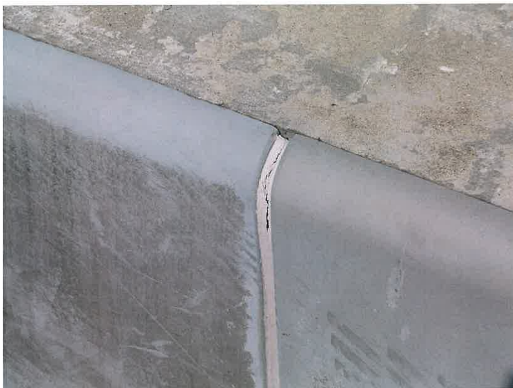
Fot. 25 – pęknięcie masy uszczelniającej styki desek gzymsowych ściany oporowej
