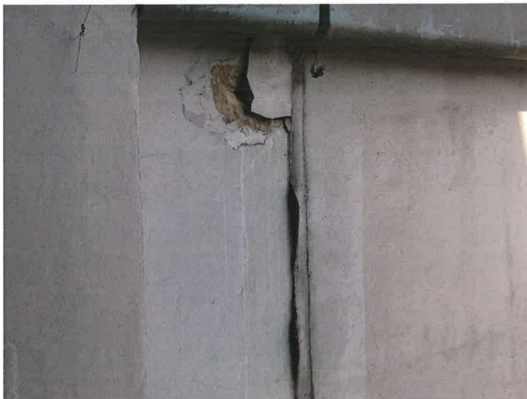
Fot. 16 – odspojenie uszczelnienia dylatacji pomiędzy przyczółkiem a murem oporowym, ubytek betonu spowodowany zablokowaniem dylatacji
