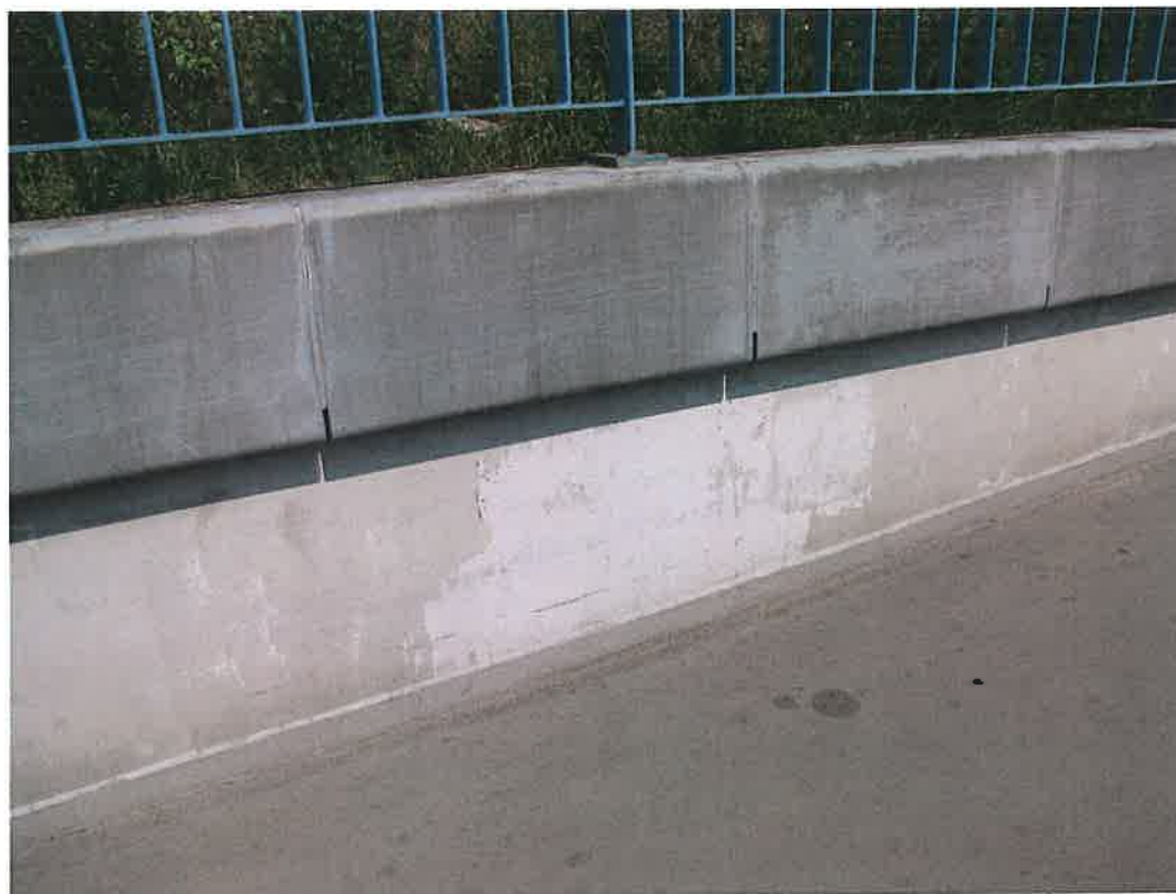
Fot. 28 – złuszczenie powłoki ochronnej do betonu na powierzchni ściany oporowej
