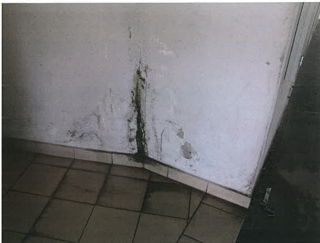
Fot. 19 – wyciek z zarysowania powstałego na styku przyczółka i łącznika do szybu windy
