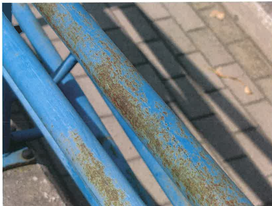
Fot. 30 – korozja przeciągów balustrady na pochylni
