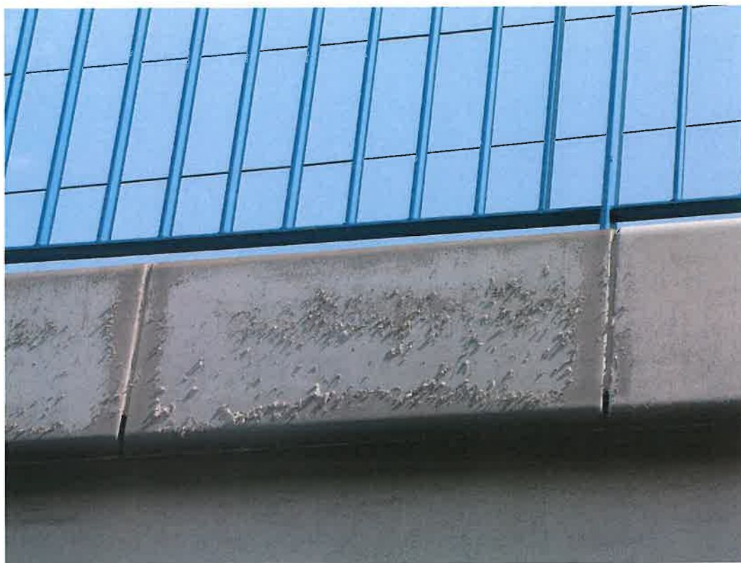
Fot. 27 – ubytki warstwy nawierzchniowej powłoki ochronnej desek gzymsowych ściany oporowej
