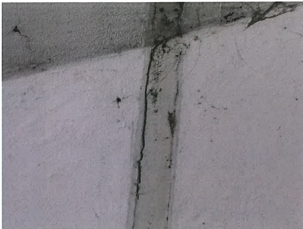
Fot. 15 – odspojenie uszczelnienia dylatacji pomiędzy przyczółkiem a murem oporowym
