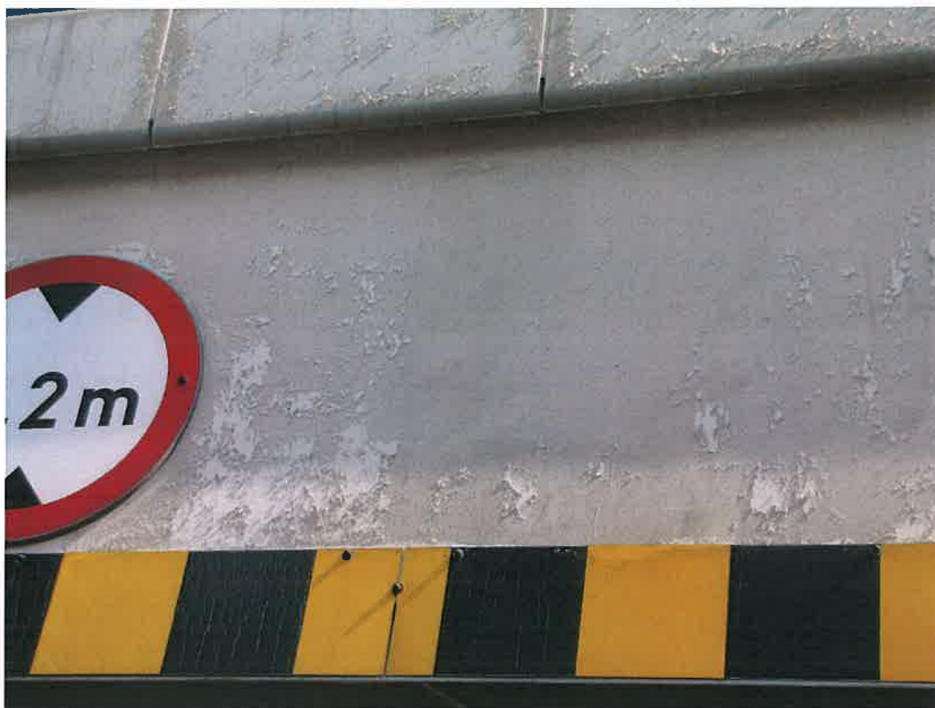
Fot. 13 – złuszczenie powłoki ochronnej do betonu na czole przęseł i deskach gzymsowych
